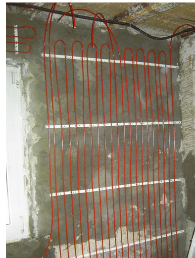
Bei der Nassvariante werden die Rohre in Klemmschienen auf der Rohwand eingedrückt, an die Zuleitung angeschlossen und danach verputzt. (Foto: JOCO)
